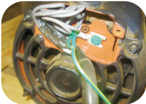
Punto de descarga a tierra existente en el motor.
